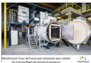
MetaFensch: Four de fusion par induction avec cellule de préchauffage de moules/carapaces
